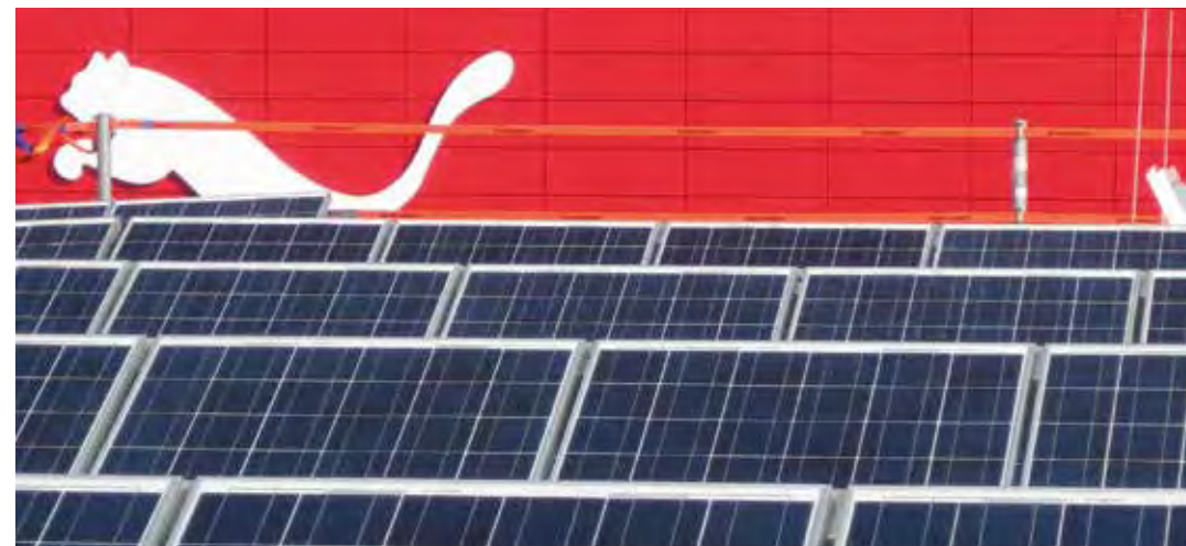
Solaranlage an PUMAs Unternehmenszentrale in Herzogenaurach
